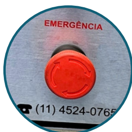
Botão de emergência
