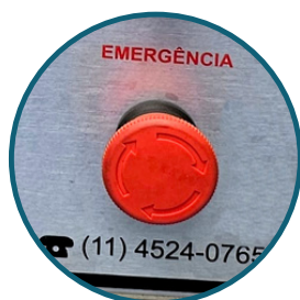
Botão de emergência
