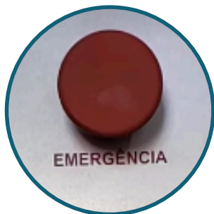
Botão de emergência
