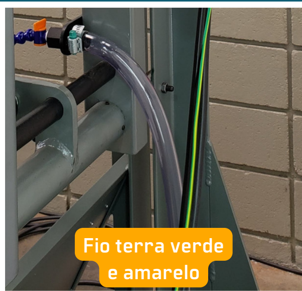
Sistema de refrigeração
