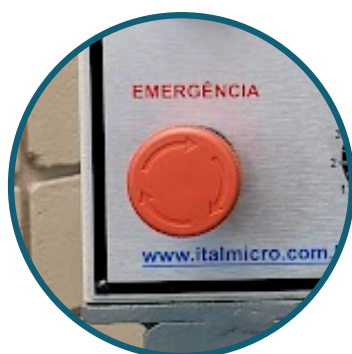
Botão de emergência
